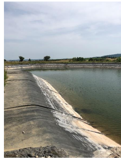
Der Speicherteich dient der Tröpfchenbewässerung (Fa. Parga) am Weingut Hardegg als Wasserquelle, Bild Simon Wirkert, ÖKL
