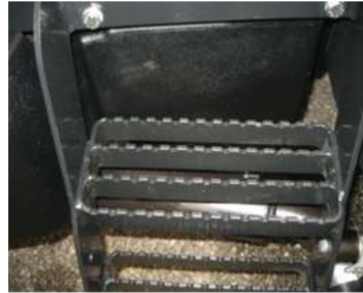
Flachstähle mit glatter Oberfläche – nicht rutschsicher
